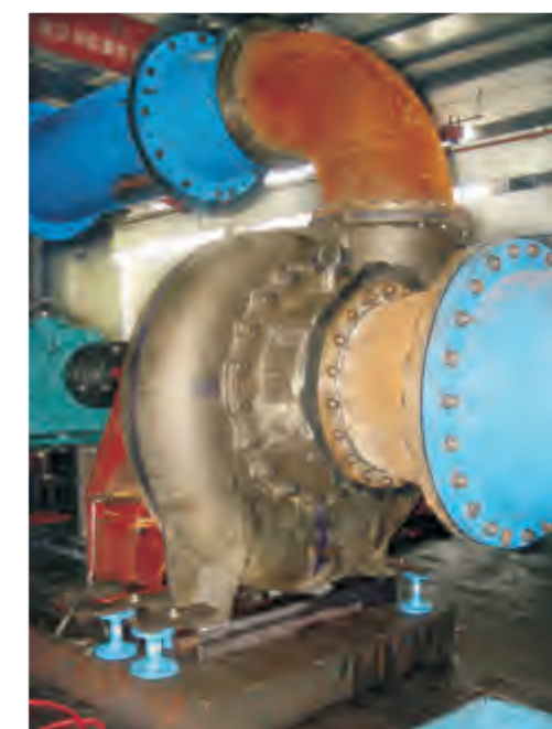
□ 脱硫泵测试现场 desulfurizing pump test
